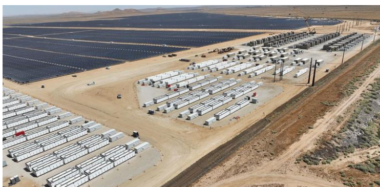
Le projet d'énergie solaire et de stockage d'Edwards & Sanborn en Californie est désormais entièrement en ligne, avec 875 MWdc d'énergie solaire photovoltaïque et 3 287 MWh de capacité de système de stockage d'énergie par batterie (BESS), ce qui en fait le plus grand projet au monde.
