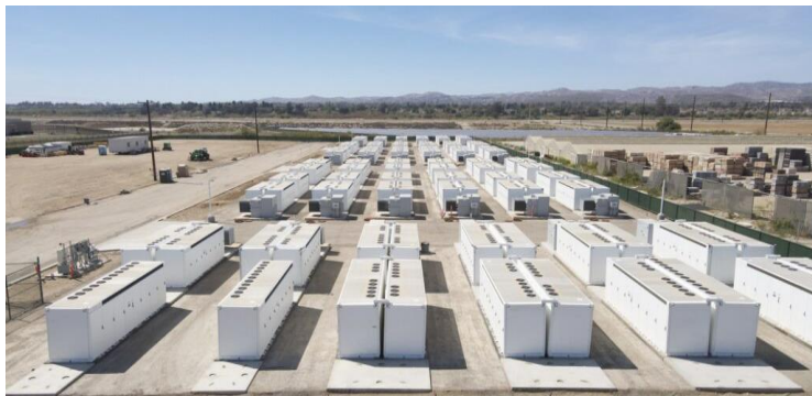
Tesla Megapack : Plusieurs systèmes de stockage d'énergie (ESS) conteneurisés de 100MW/400MW/h
