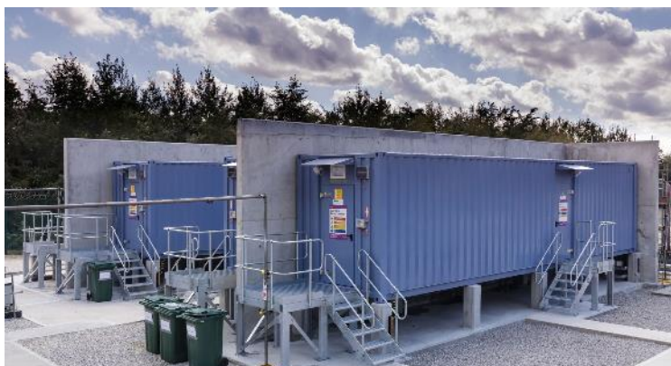
Murs résistants au feu entre les BESS
