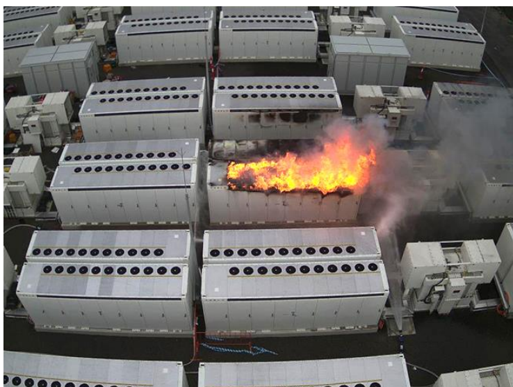
Feu de BESS - TESLA - Moss Landing - 2022
